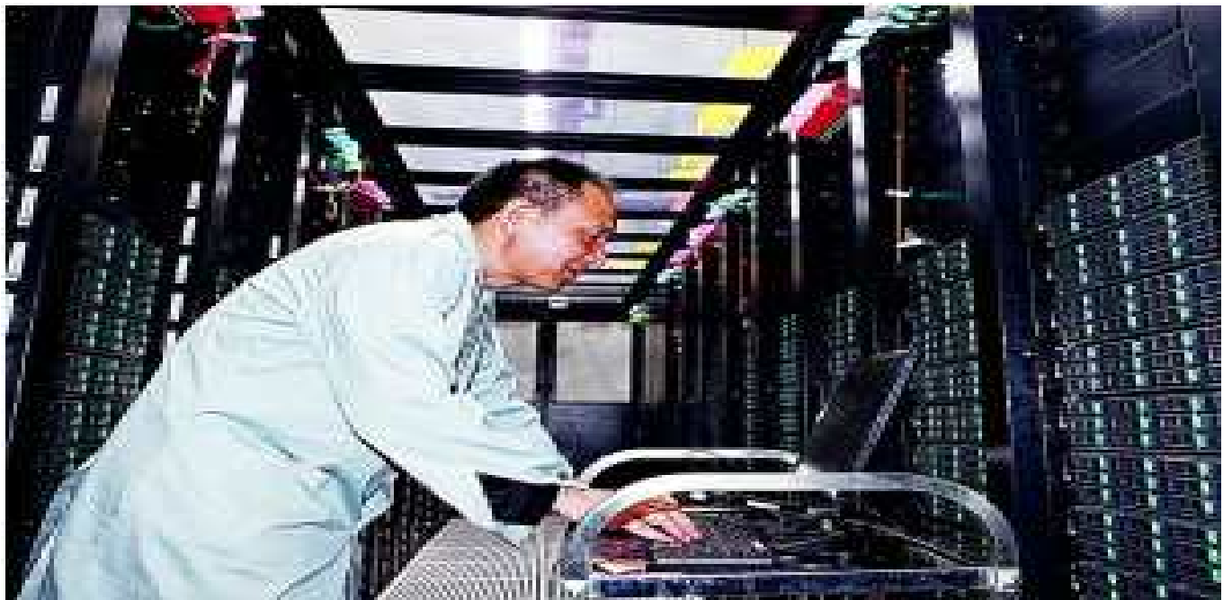
△칭다오 차이나유니콤 인터넷데이터센터(IDC) 내부 모습(칭다오 차이나유니콤 제공).
